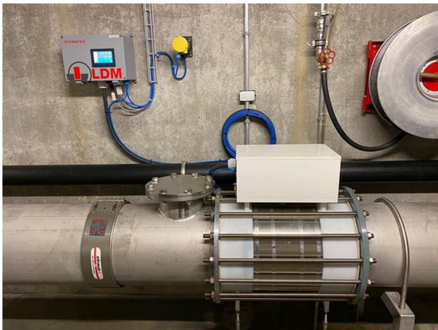
Figure 1 : LDM partiellement rempli installé. La fourniture et l'instruction de mesure du débit ont été effectuées par STEBATEC. Le montage, la tuyauterie en acier inoxydable, le raccordement électrique et le branchement ont été réalisés par le client.
