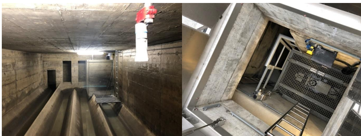
Abbildung 2. Links: An der Abflussseite wurde ein Schacht gebaut damit ein pneumatischer Abflussregler eingesetzt werden konnte. Im Regenfall wird hier gedrosselt, um das Volumen des Beckens zu nutzen. Rechts: Der Einstieg zum Drosselschacht, dieser ist nach dem Umbau grosszügig und sicher.
