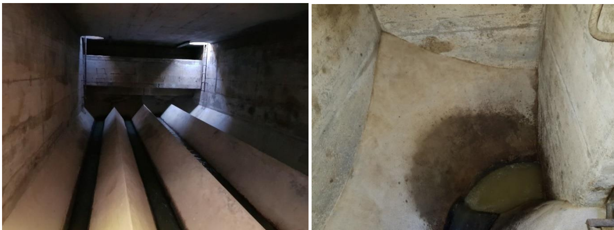
Abbildung 1. Bei Trockenwetter fliesst das Wasser in Zickzack zwischen den 'Toberone Strukturen'. Bei Regenwetter und Befüllung des Beckens, kann das Wasser im Entlastungskanal, links sichtbar am Ende vom Becken, entlastet werden. Rechts: Kurve direkt nach dem Ablauf des Regenbeckens Dättнау. Nach der Kurve war das Rohr nicht zugänglich, weshalb neu innerhalb des Beckens eine Abtrennung zur Integration der pneumatischen Abflussregelung gebaut wurde.
