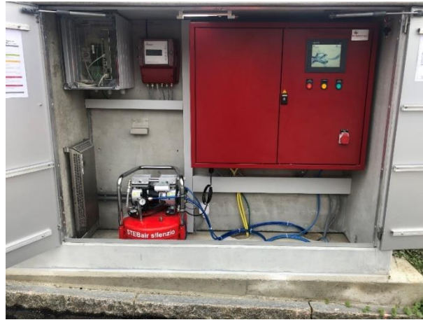
Abbildung 3. Kabine mit der STEBATEC Steuerung, Kompressor und Heizung. Die Datenverbindung mittels Lichtwellenleiter zum PLS ist Links oben erkennbar.
